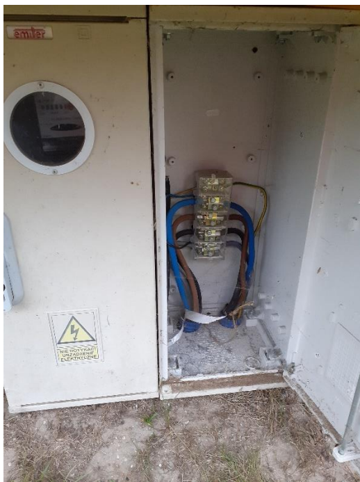
Zdjęcie 2. Przyłącze elektryczne domku
